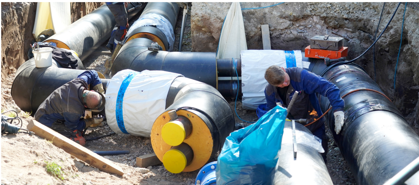
Агентство KEA-BW поддерживает муниципалитеты различными способами, включая планирование отопления и строительство местных тепловых сетей
